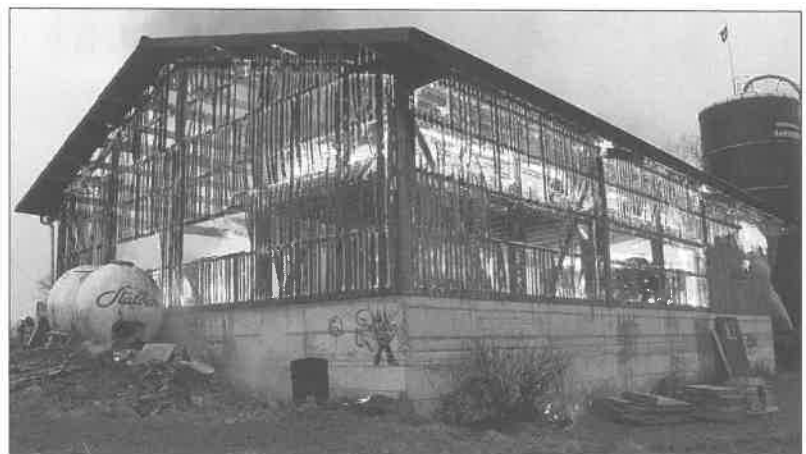
Die Maschinenhalle bei der Liegenschaft Lohren (Ballwil) steht im Vollbrand. Es entsteht ein Schaden von rund 150 000 Franken.
